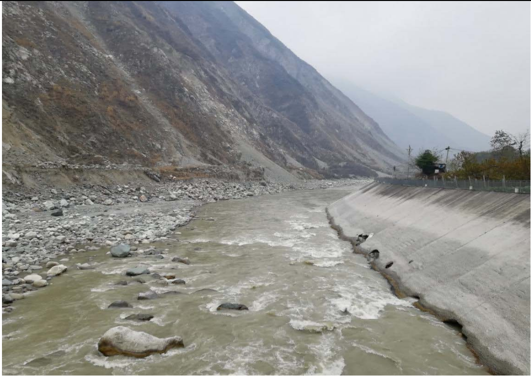
图 1-5 已建堤防面板局部有冲坑
