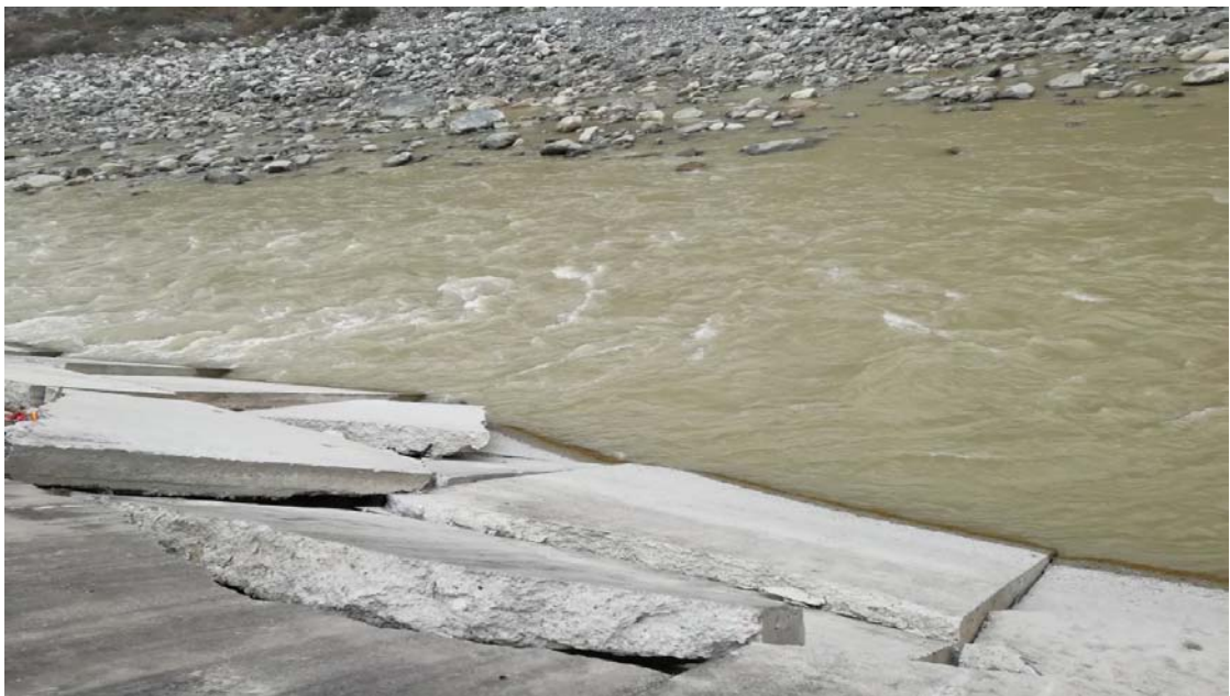
图 1-6 已建堤防面板垮塌
