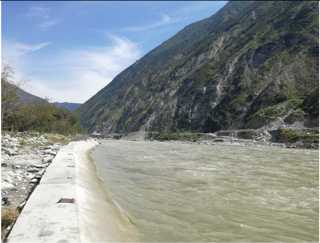
图 1-7 已建堤顶栏杆毁坏
