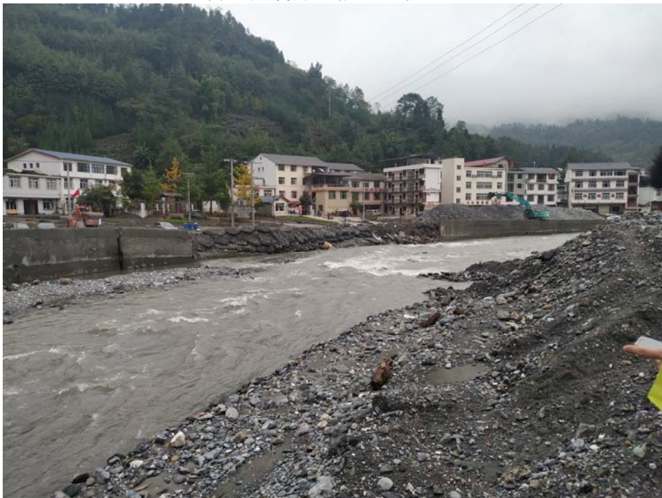
街村段堤防倒塌现状
