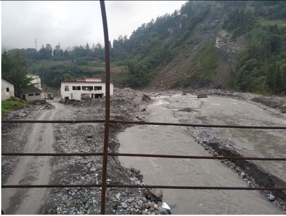
街村段河道淤积、左岸堤防冲垮、右岸堤防掩埋现状图
