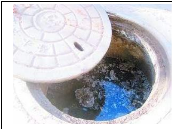
图 1-1 污水井淤堵现状图
